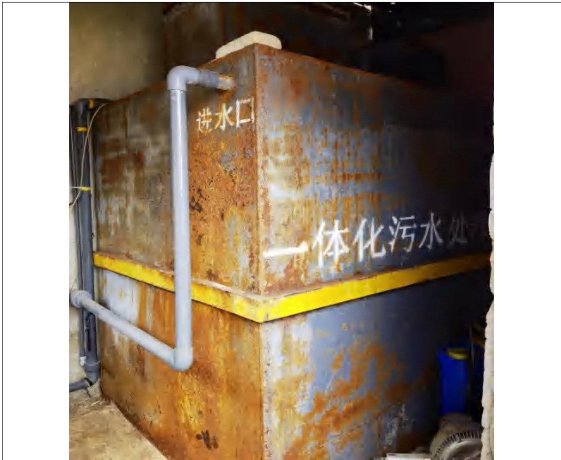
污水处理设施
