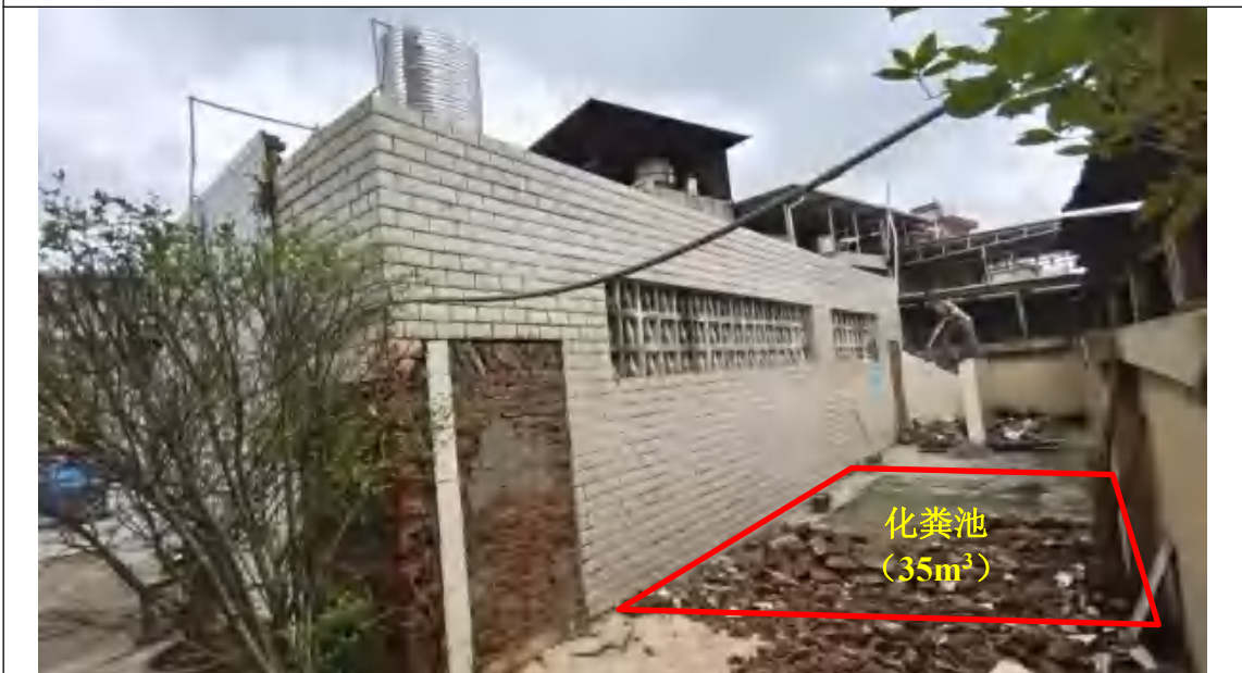
公共厕所化粪池
